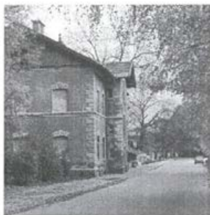
Nad sto let stara železniška stanovanjska zgradba v Velenju je potrebna temeljite prenove (foto A. Sore)
